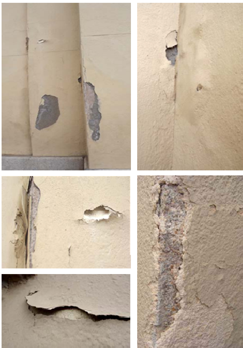
Abombaments i despreniments en la capa d'estuc
