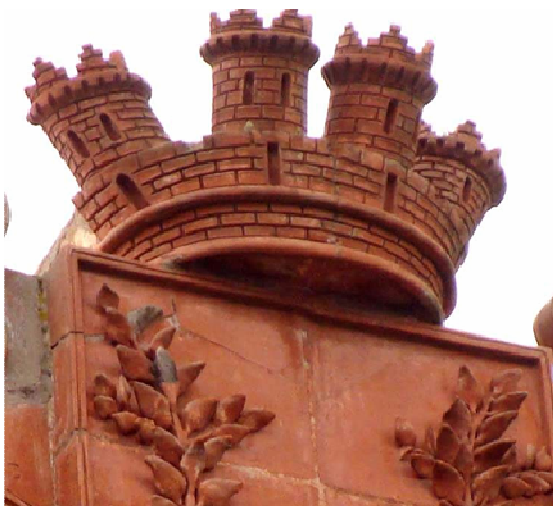
Fissures i fractures de material
