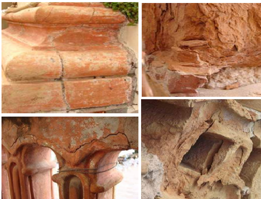
Pèrdua de fermesa estructural del material (fractures i disgregació) per presència de sals.
