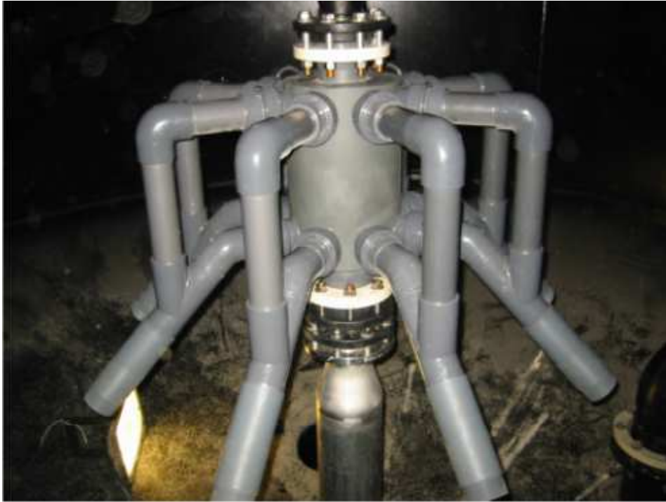
Ejectors aire en tanc de nitrificació.
