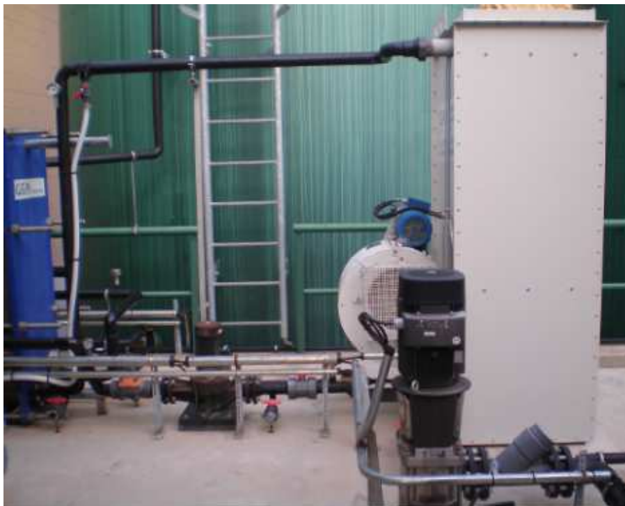
Torre de refrigeració
